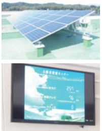
寄贈された太陽光発電設備とモニター
